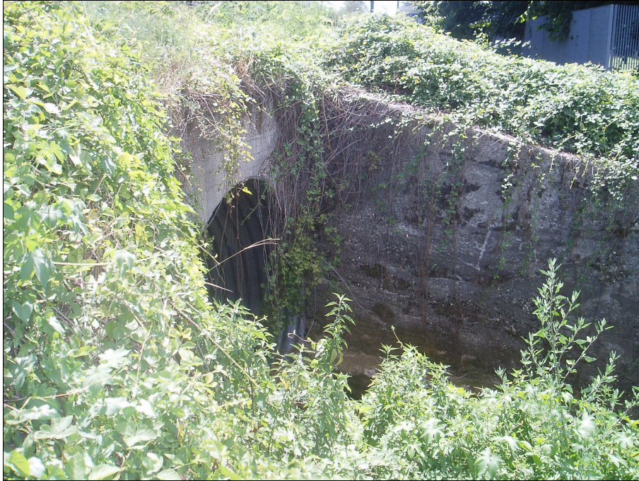
Foto 3 - Rio Garosso di Rivalta – Attraversamento della S.P. 143 (visto da monte, con presenza di erosioni al piede della sponda destra)
